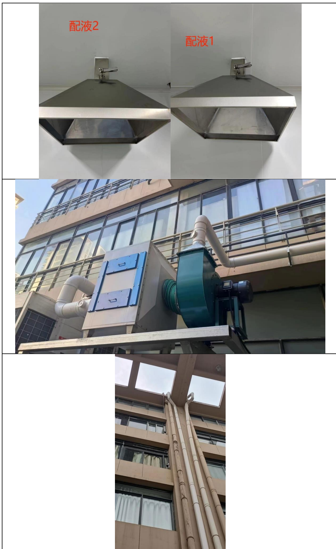
图 4-3 废气收集、处理设施照片
